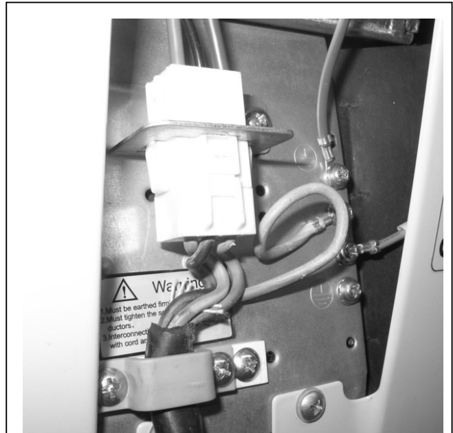
Elektrischer Anschluss am Außenteil
